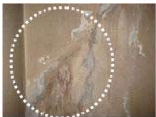
図表6-4-7 宮前連絡所の室内漏水跡
