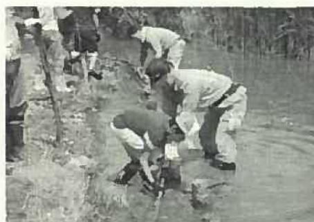
【図3-51】せせらぎ池の粗朶柵づくり 提供：かわさき水辺の楽校
