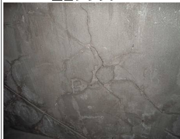
壁面クラック
