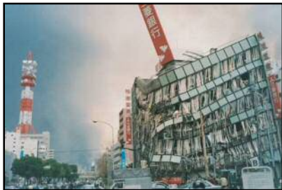
阪神・淡路大震災の様子 写真:神戸市役所
