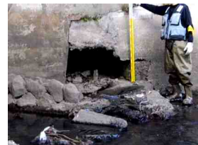
護岸背面部の空洞
