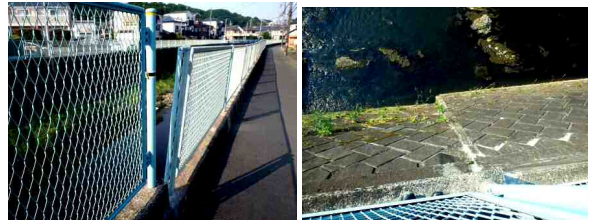
変状による護岸施設の見違い
