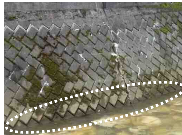
護岸の変状(ブロック隙間の拡大)
