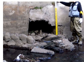
護岸背面部の空洞
