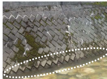
護岸の変状(ブロック隙間の拡大)
