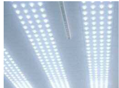
庁舎等建物内照明LED化の推進
