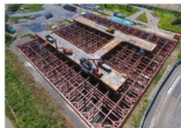
等々力水処理センター高度処理事業
