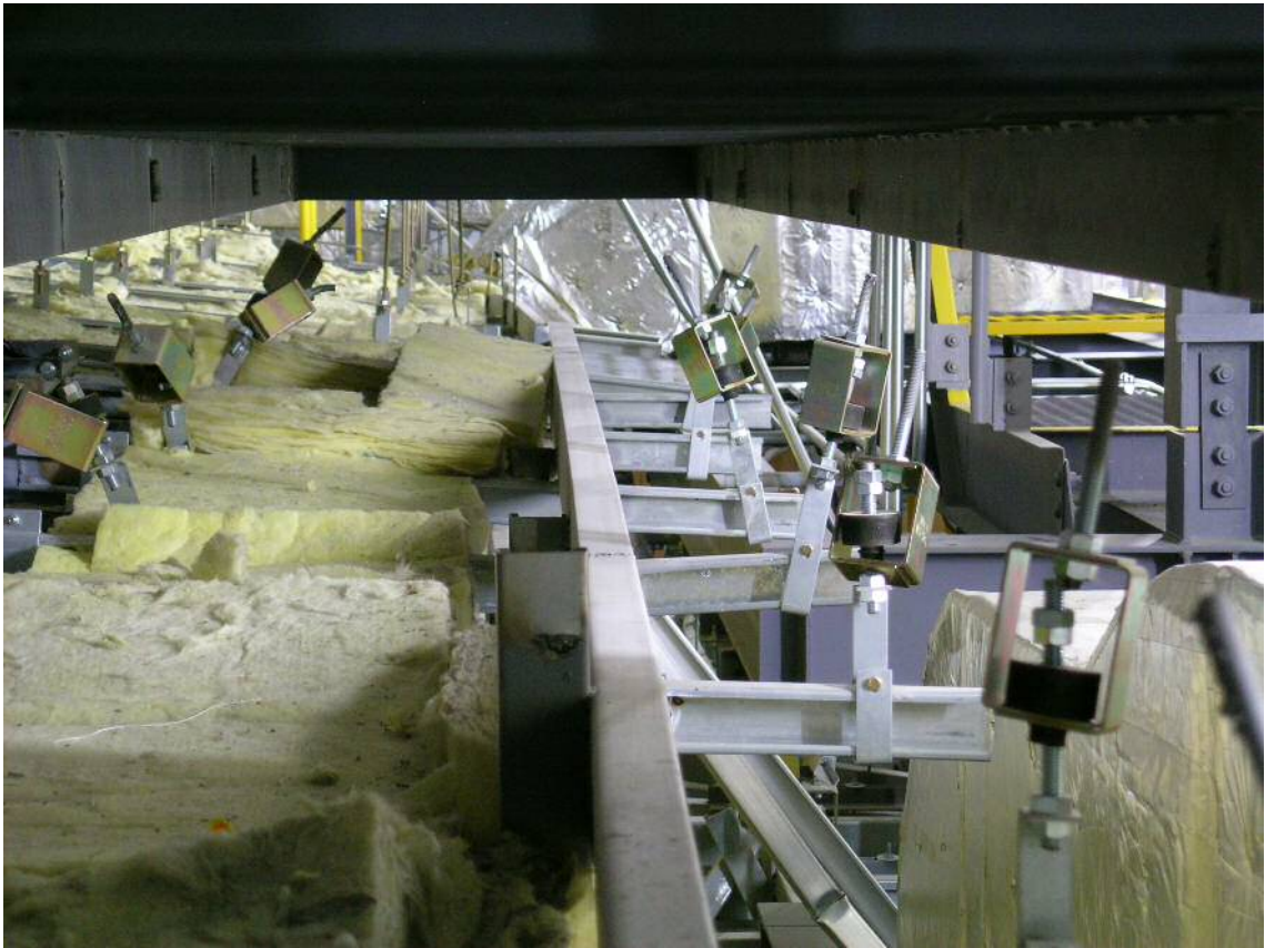
写真 5.3.13 上手の未落下天井立上りの直上—キャットウォーク下の溶接吊元が全て脱落 (撮影 2011.12.9)
