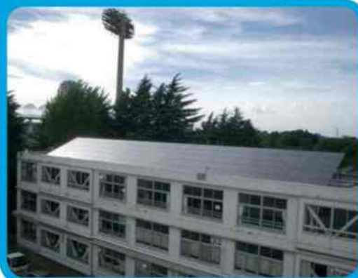
西丸子小学校に設置された太陽光パネル
