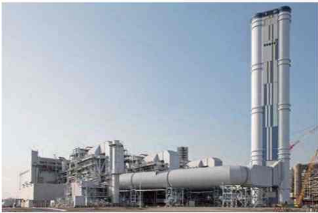
川崎火力発電所のMACC発電
