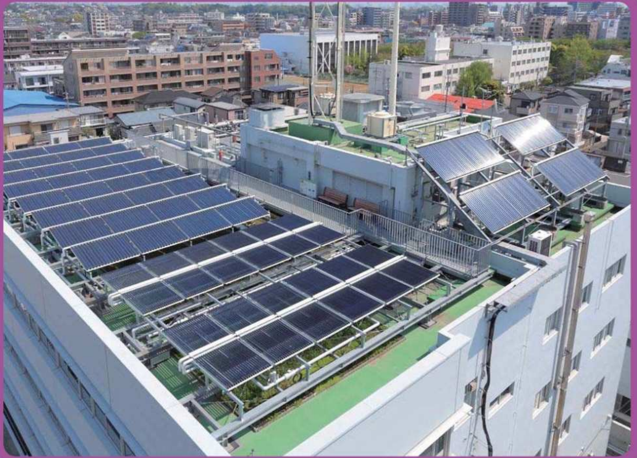
東京ガス中原ビルに設置されたソーラークーリングシステム
