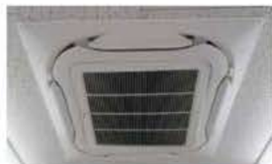
▲空調設備の更新例
