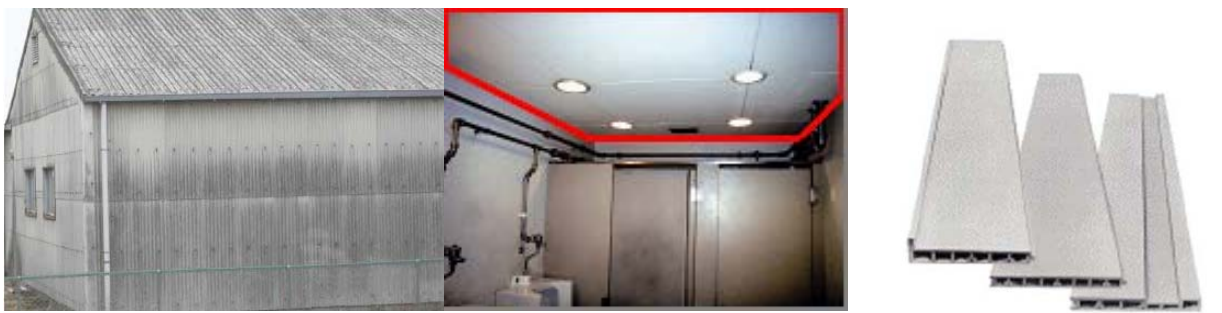
石綿含有スレート波板
