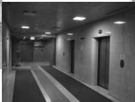
第3庁舎エレベーターホール LED照明
