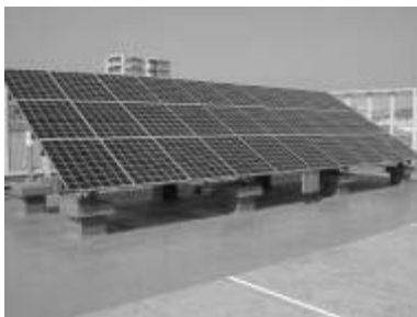
太陽光発電設備 (麻生区役所)
