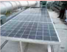
約1kWの太陽光パネル
