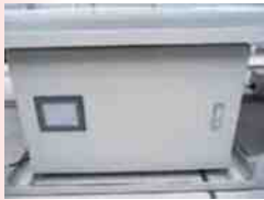
直流電源装置
