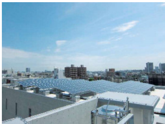
太陽光発電設備（幸区役所）
