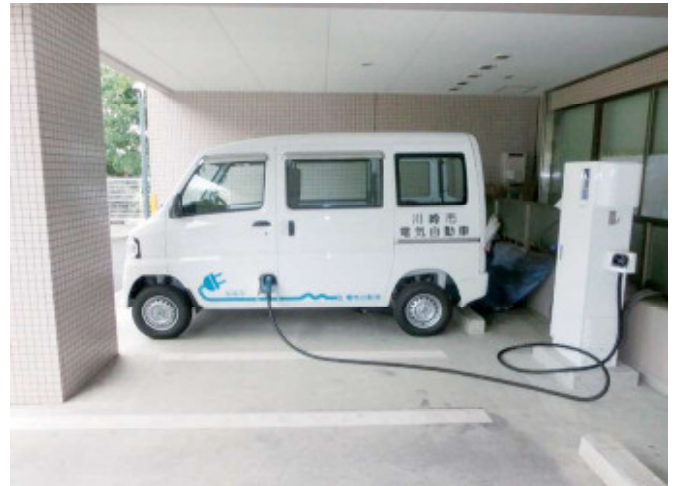
幸区日吉合同庁舎に導入した電気自動車と充電・給電設備
