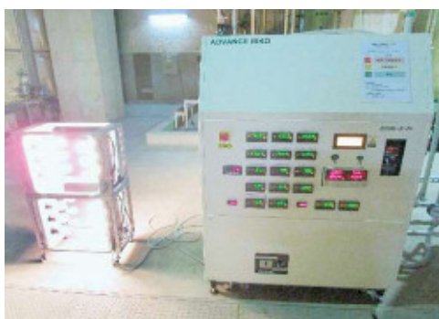
共同研究により実証を行った 工場の温排水を利用した可搬型小型発電システム
