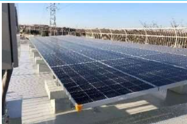
南原小学校に導入した太陽光発電設備
