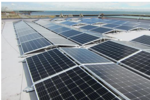
< 太陽光発電設備 >
