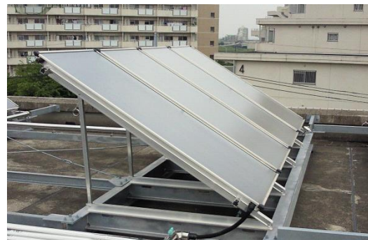
< 太陽熱利用設備 >
