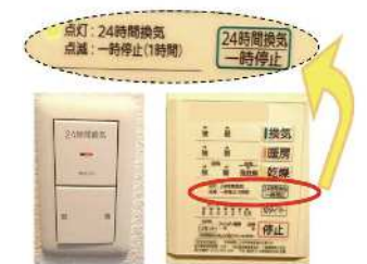
24時間換気システム
