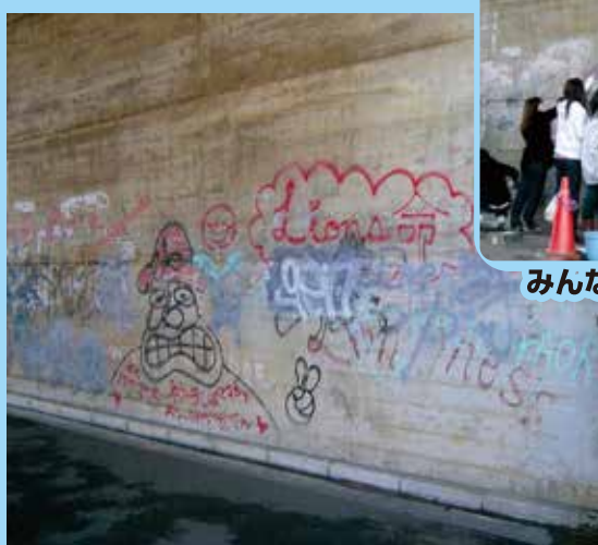
落書きされていたトンネルの壁
