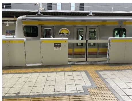
JR南武線武蔵小杉駅ホームドア （令和3年度整備完了）
