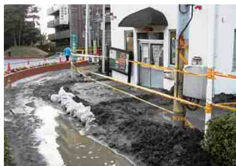
図 液状化による被害状況 (出典：災害写真データベース)
