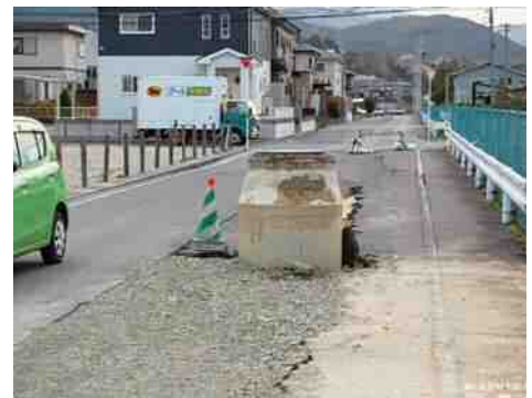
図 液状化によるマンホール等の浮き上がり (出典:災害写真データベース)
