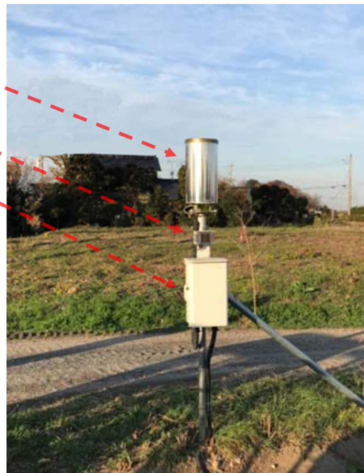
～水位計・雨量計の設置～
