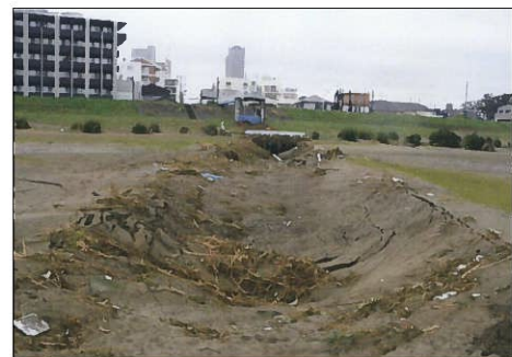
写真: 排水樋管周辺状況(台風後)
