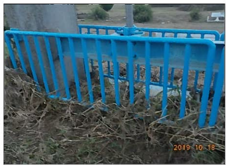
写真: 扉体上部状況(台風後)
