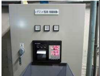
デマンド監視装置（本庁舎）
