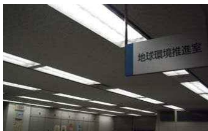
蛍光灯のLED化（第3庁舎17階）
