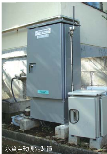
水質自動測定装置 水道水の色やにごり、消毒の効果（遊離残留塩素）は、市内20か所に設置している水質自動測定装置で測定しています。
