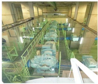
生田浄水場 工水2号送水管送水ポンプ
