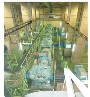
生田浄水場 工水2号送水管送水ポンプ
