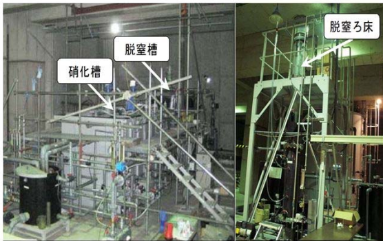
研究開発中の高度処理技術の実験プラント
