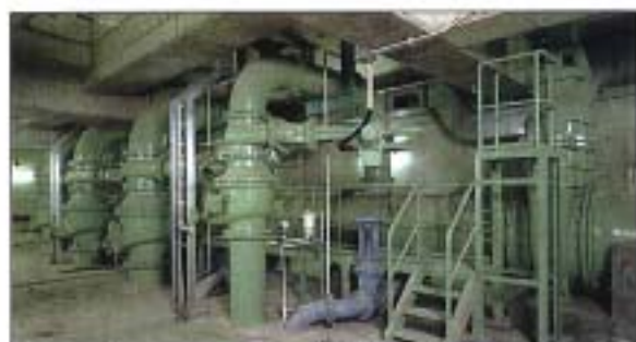
主ポンプ 沈砂池を経由した下水を最初沈殿池へ送る設備です。
