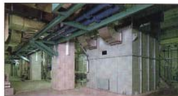
脱臭設備 薬品と活性炭を利用して下水の処理過程から発生する臭気を取り除く設備です。
