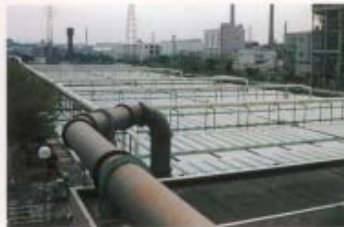
西系エアレーションタンク
