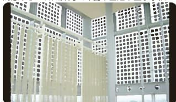
太陽光発電パネル壁と井水冷房の輻射パネル（手前）（昭和町立押原小学校）
