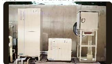
燃料電池による給湯（武蔵野市立大野田小学校）
