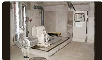
空調循環水の水力発電（私立田園調布学園）
