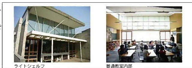
ライトシェルフ 普通教室内部 ライトシェルフにより日照の調節がされた南向きの教室（愛知県瀬戸市立品野台小学校）
