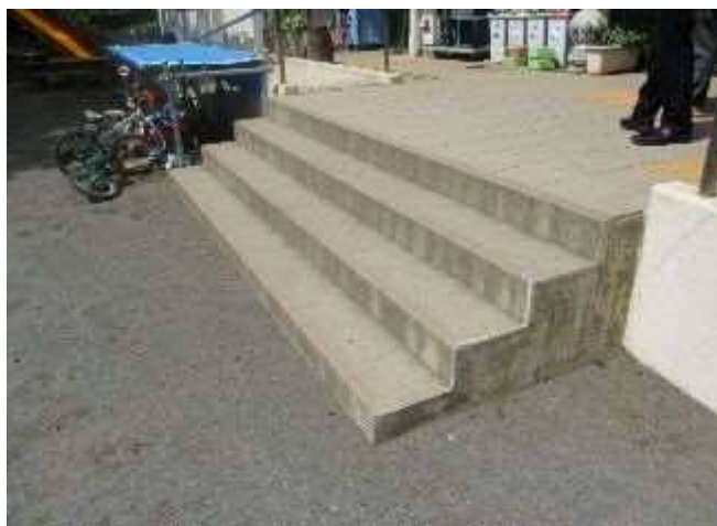
図8 敷地内通路の階段に手すりが設置されていない（菅生こども文化センター）
