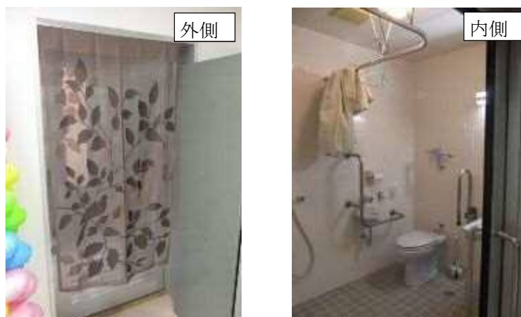
図 66 多機能トイレがあることを示す表示がない(幸こども文化センター)
