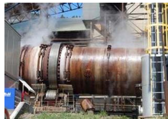
セメント焼成炉（可燃物を処理）
