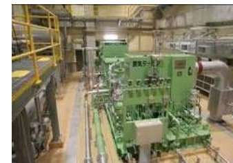
【タービン発電機】最大7,500kw
