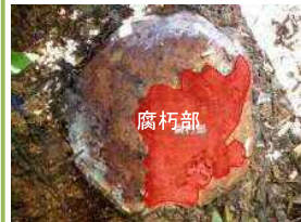
図6 切断面の腐朽状況(腐朽率37%)
