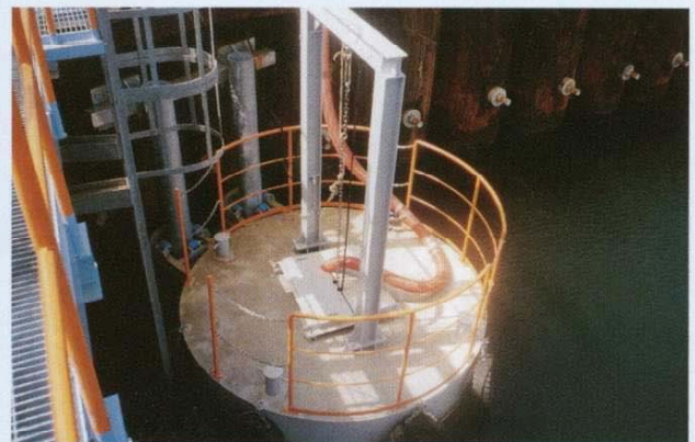
原水揚水ポンプステージ
