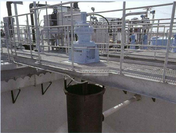
第1凝集沈殿汚泥掻寄機
