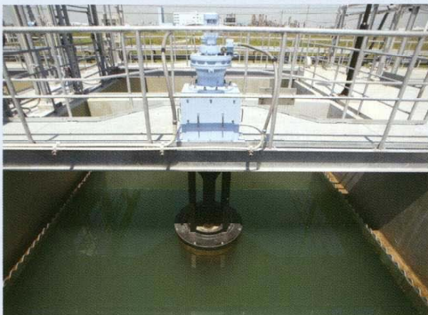
第2凝集沈殿汚泥掻寄機
