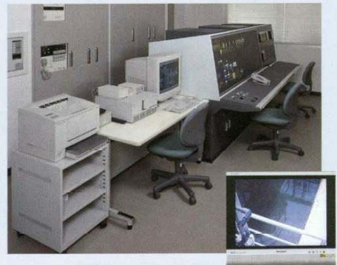
第2凝集沈殿槽監視モニター
