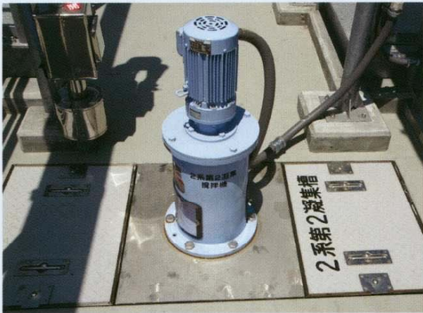
第2凝集攪拌機
