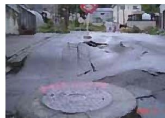
液状化による被害状況 (平成16年新潟県中越地震)
