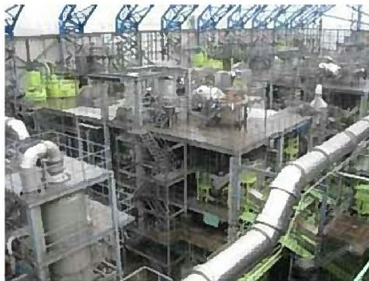
入江崎総合スラッジセンターの汚泥焼却施設
