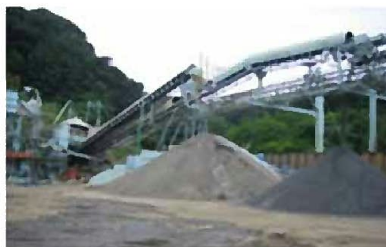
粒状改良土プラント
