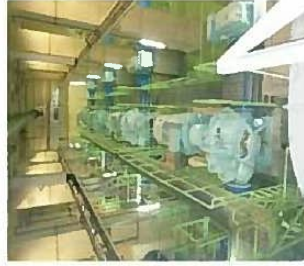
生田浄水場 工業2号送水送水ポンプ
