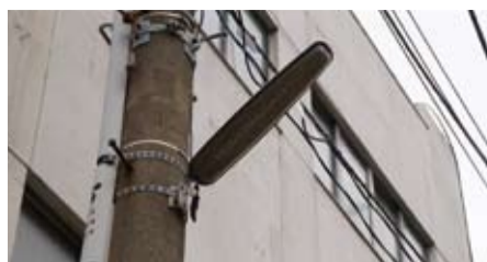
町内会・自治会で設置している防犯灯
