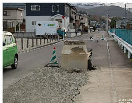
図 液状化によるマンホール等の浮き上がり (出典:災害写真データベース)
