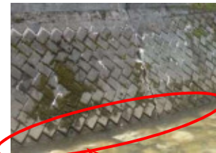
護岸の変状 (ブロック隙間の拡大)
