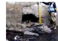
護岸背面部の空洞
