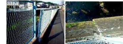
変状による護岸施設の目違い
