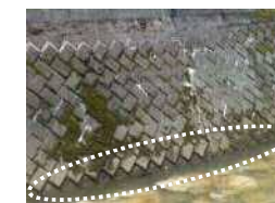
護岸の変状(ブロック隙間の拡大)
