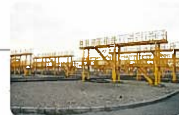
リーファー電源 Power points for a refrigerated container
