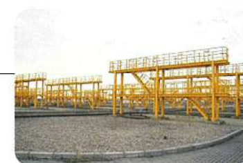
リーファー電源 Power points for a refrigerated container
