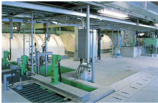
排水処理設備
