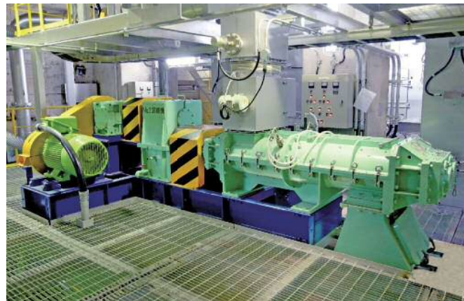
飛灰安定化装置
