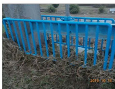
扉体上部状況(台風後)
