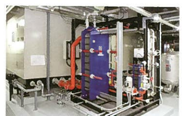
●コージェネレーションシステム
