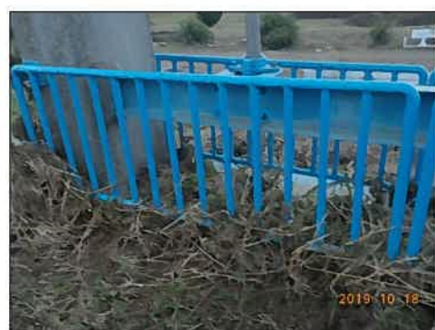
扉体上部状況(台風後)
