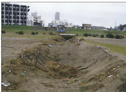
排水樋管周辺状況(台風後)
