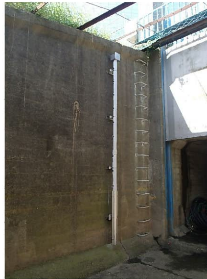
外水位計（河川水位）
