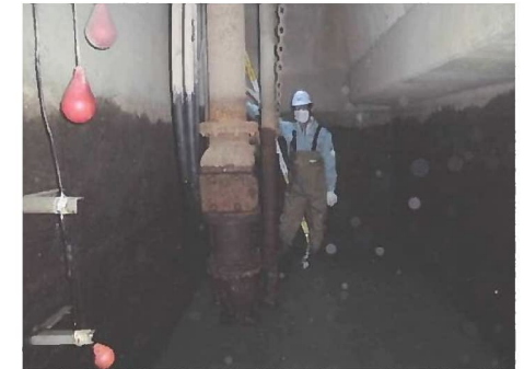
写真② 仮排水所内ポンプ
