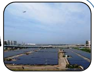
浮島太陽光発電所
